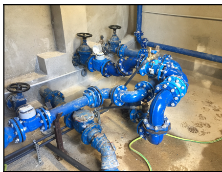
Panoplie hydraulique réhabilitée
