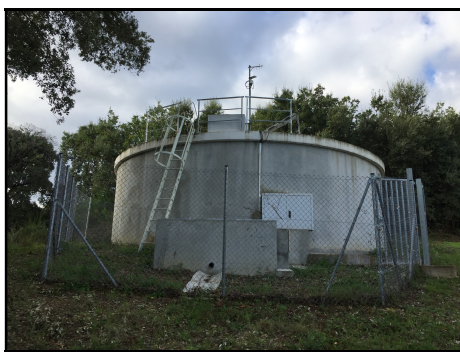
Réservoir de Palazzi
